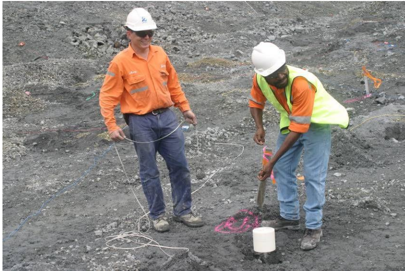
Figura 3. Instalação do monitor de movimento BMM (cilindro branco na boca do furo)
